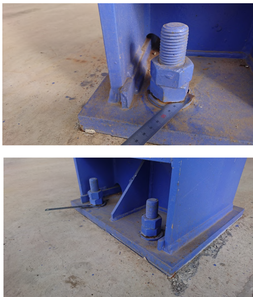
写真3 熊本地震で塑性変形したABR アンカーボルト（震源地付近）
